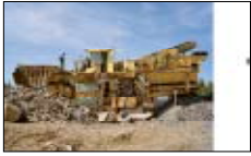
24 Kivenmurskain, 2004 Stenkrossaren Rock crusher
